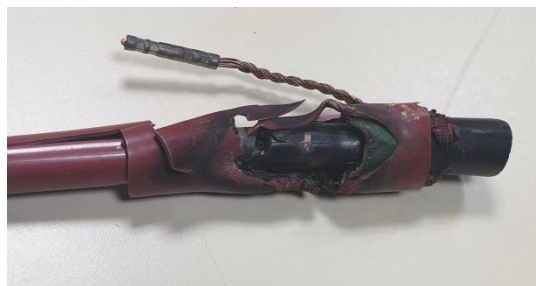
Slika 5. Oštećenje na kablskom završetku uslijed proboja
