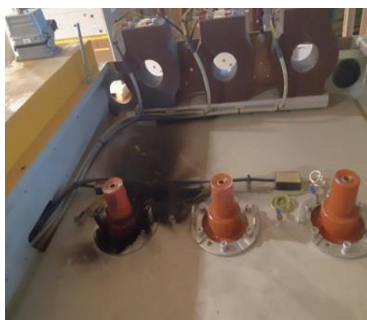
Slika 11. SN sklopni blok s izolatorom u kvaru
