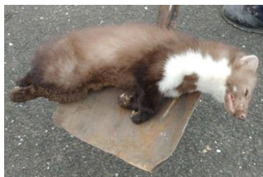
Slika 14. Kuna nakon pogibije na transformatoru
